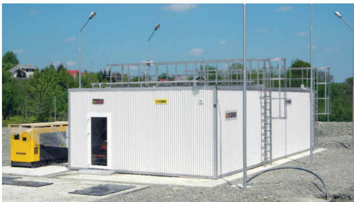
Unul dintre elementele foarte importante ale instalației de canalizare: stația de epurare
